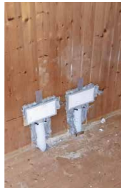
Die größte Herausforderung in der Sanierung ist es, die Luftleitungen zu „verstecken“.
