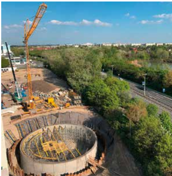
Bau des 1500 m 3 großen Eisspeichers im Zuge der Errichtung des IKEA-Logistikzentrums in Wien Foto: IKEA
